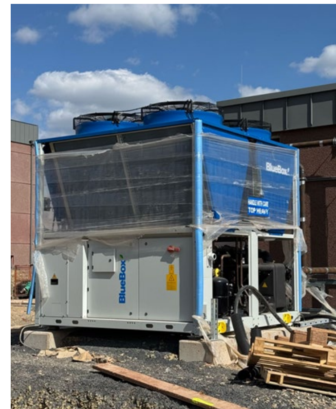
Polyvalente Wärmepumpe, Reckrod 2
